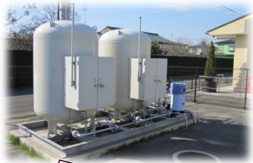
介護施設へのLPガスマルチ供給
