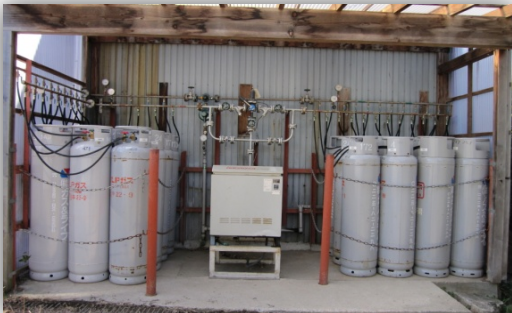
製菓工場へのLPガス供給 ボンベ庫
