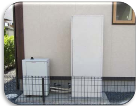
エコウィル設置（オールガス住宅） LPガスでエンジンを動かし電気を発電し排熱を利用して給湯と暖房に使用
